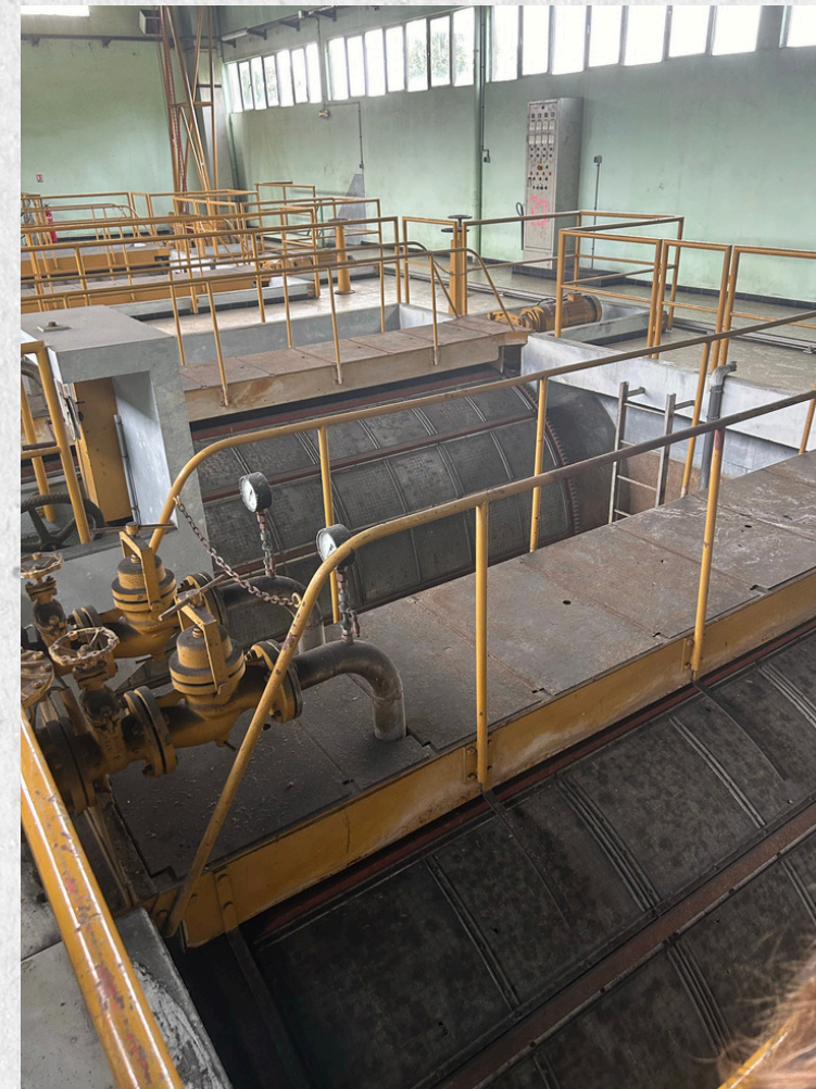
Cuves pour le traitement des macrodéchets
