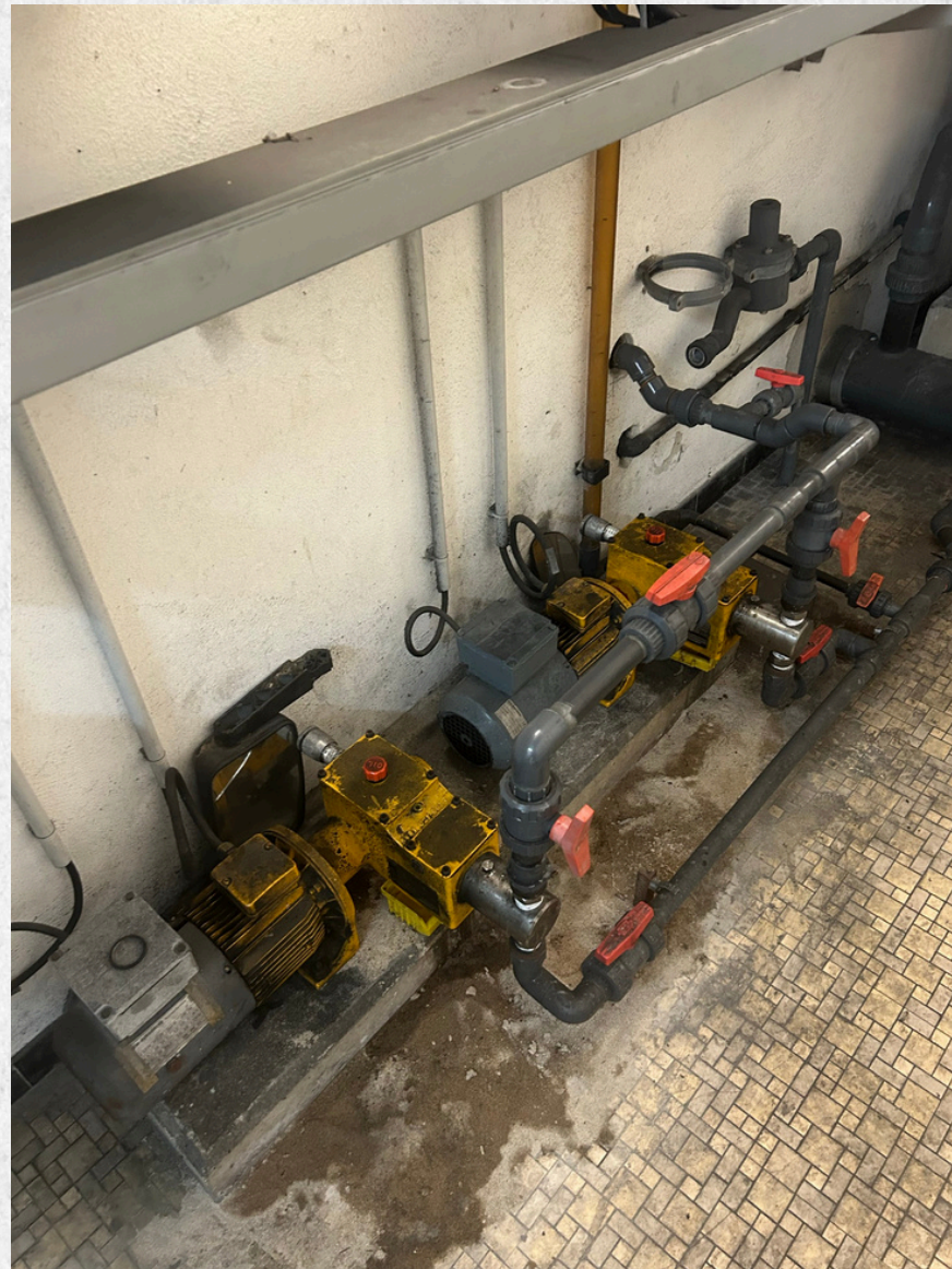
Systeme d'activation du bac à décantation
