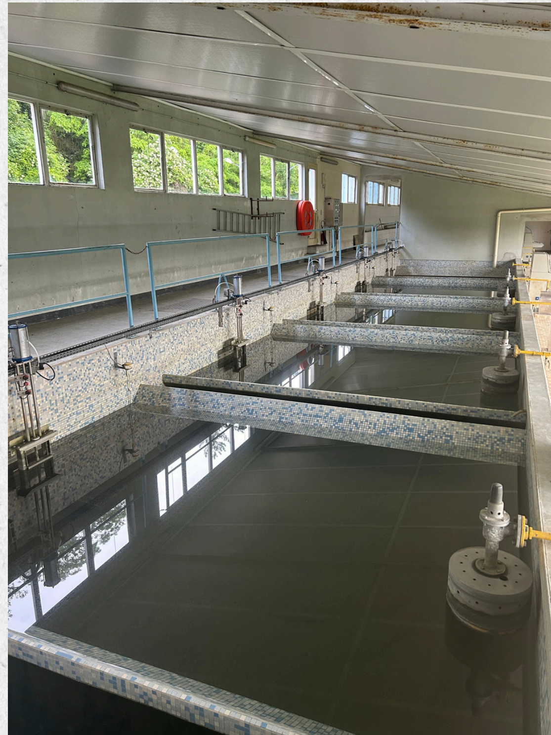
Bac de filtration à sable et gravier
