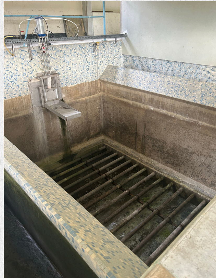
Bac à décantation
