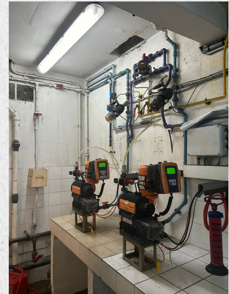
Traitement avec du chlore
